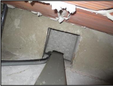
Photo N° 1141 AMIANTE CIMENT -- placards technique rdc à +7 Planchers Plaques planes (Fibres- ciment)
